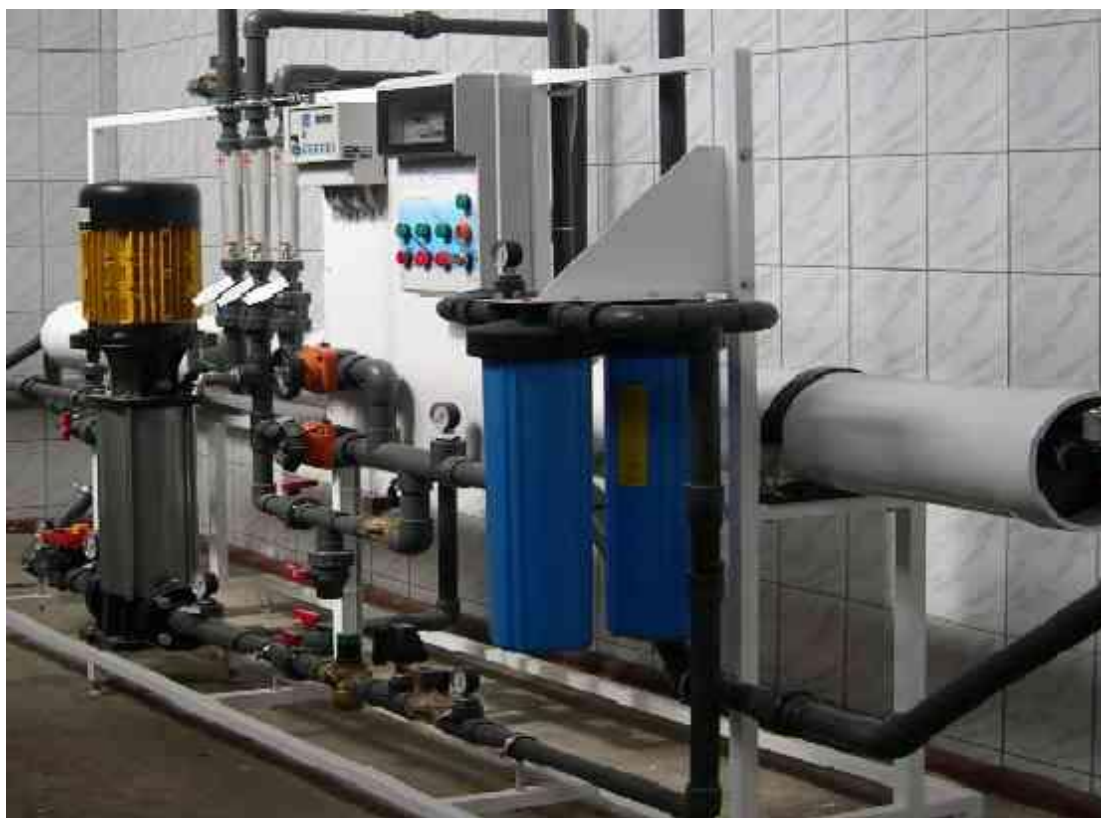
Установка обратного осмоса ООО «Интер-Качество»
