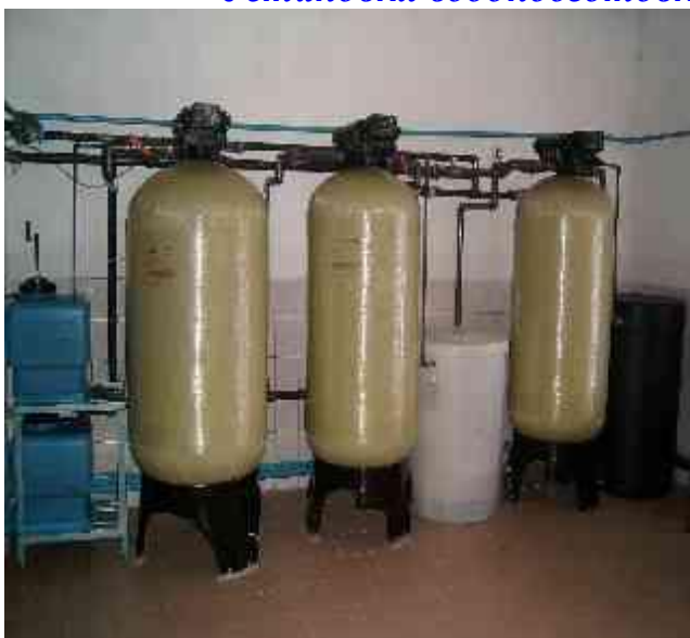
Водоподготовка ООО «Бочкаревский пивоваренный завод»
